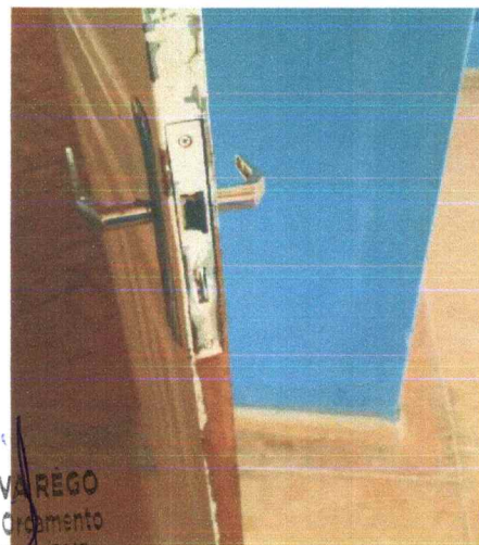
Figura 121 – FECHADURA DANIFICADA DO PÁTIO.
