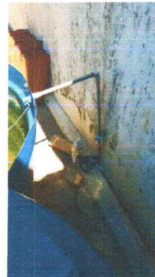
Figura 64 – INSTALAÇÃO HIDRAÚLICA EXPOSTA DANIFICADA 2.
