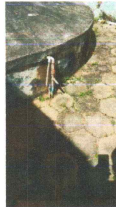
Figura 63 – INSTALAÇÃO HIDRAÚLICA EXPOSTA DANIFICADA 1.
