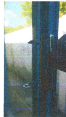
Figura 27 – TRINCOS DANIFICAÇÕES NAS JANELAS 1.
