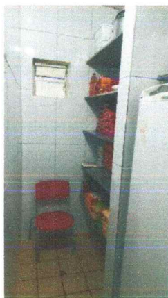
Figura 32 – NÃO PERMITE AMPLIAÇÃO (JÁ POSSUE BANCADAS DE GRANITO, REVESTIMENTO CERÂMICO E TELAS NAS ESQUADRIAS DE VENTILAÇÃO).
