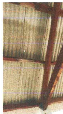
Figura 81 – TELHA FURADA (SUBSTITUIR FOLHA).
