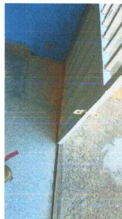
Figura 104 – ROLAMENTO DO PORTÃO CAIRAM (FERRUGEM NA BASE DO PORTÃO).
