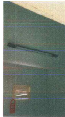
Figura 49 – LÂMPADA EM SALA DE AULA (SUBSTITUIR).
