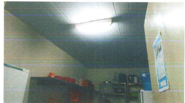
Figura 70 – SUBSTITUIR SUPORTE E LÂMPADA DO DEPÓSITO.
