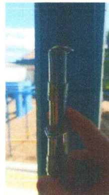
Figura 28 – TRINCOS DANIFICAÇÕES NAS JANELAS 1.
