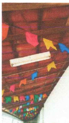
Figura 43 – LÂMPADAS NO CORREDOR (SUBSTITUIR POR LED).
