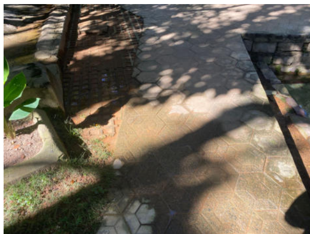
NECESSIDADE DE CAIXA DE DRENAGEM
