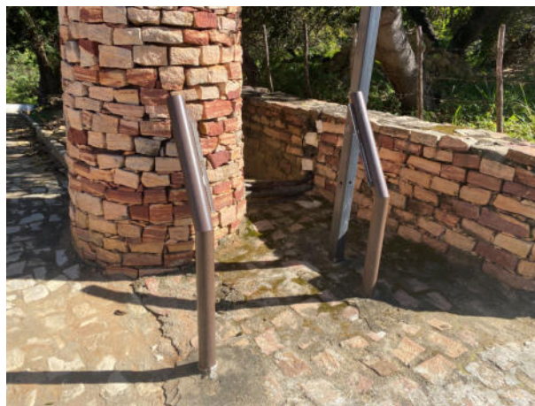
PLACA SINALIZAÇÃO FALTANDO
