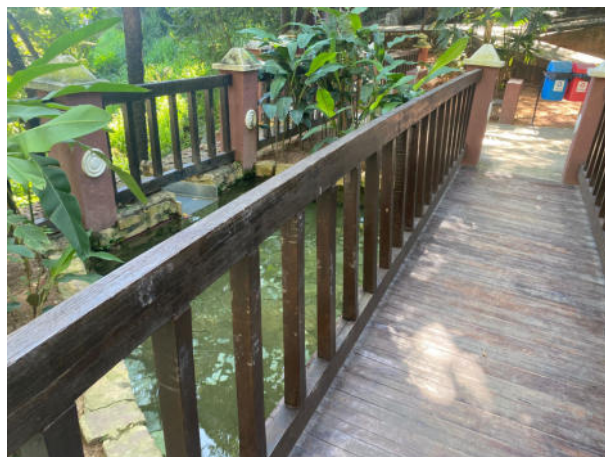
CORRIMÃO E SER SUBSTITUIDO
