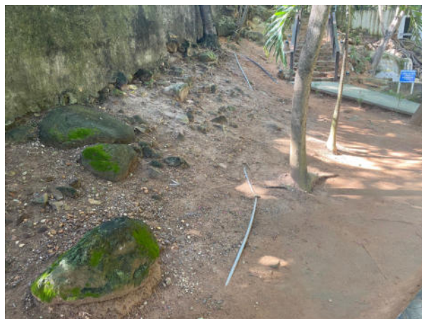
INSTALAÇÃO ELETRICA EXPOSTA
