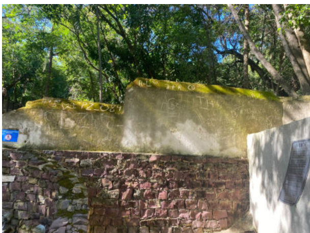
MUROS COM NECESSIDADE DE LIMPEZA E PINTURA
