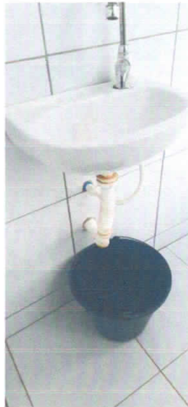
Revisão hidráulica (Sifão)
