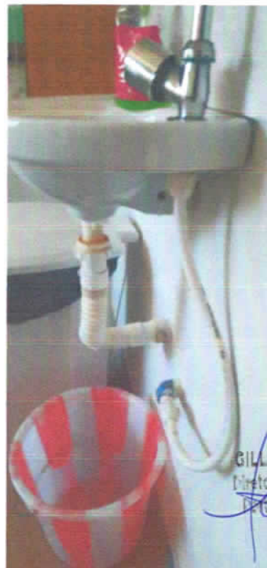
Revisão hidráulica (Sifão)
